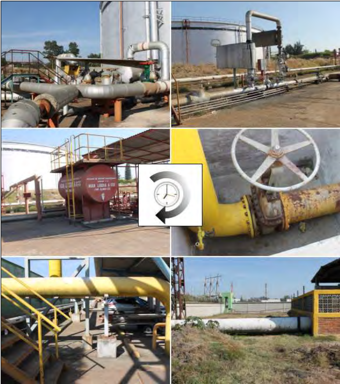
Condiciones generales de infraestructura complementaria de la CT Salamanca
