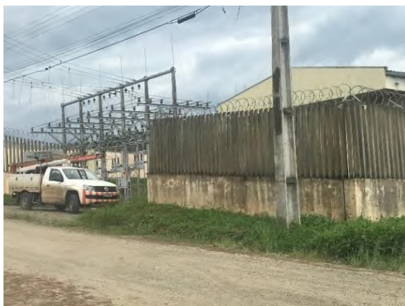
Foto 5.5.3-17: Subestação Paulo Frontin. Paulo Frontin (PR).
