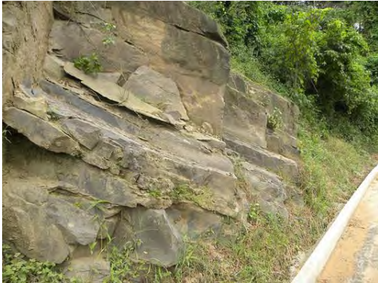
Foto 10.1-55: Detalhe de talude de corte, onde o acamamento rochoso, aliado a fraturas da rocha e associados a uma direção do talude não favorável à estabilização da rocha favorecem o escorregamento planar, envolvendo partes do maciço rochoso. Registro em talude na BR 470, próximo à confluência entre os rios Itajaí-Açu e Itajaí do Norte, Ibirama/SC. Coord.: 22 J 649151 m E 7004106 m S.
