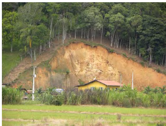
Foto 10.1-54: Detalhe de escorregamento em argissolo e material saprolítico de gnaiss, exposto em talude de corte vertical, cuja geometria associada a um incremento pluviométrico levaram a instabilização parcial do talude na região do Ribeirão São Paulo, município de Ascurra/SC. Coord.: 22 J 657623 m E 7017070 m S.
