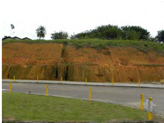
Foto 10.1-53: Caracterização de erosão linear rasa, evoluindo para profunda em talude de corte sobre rocha saprolítica, associada ao padrão de relevo definido por uma colina, local com interferência antrópica sem controle de drenagem.
