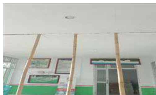
Bangunan Retak di Puskesmas Masela yang Ditopang Kayu Penyangga
