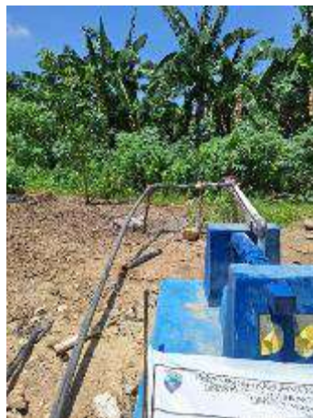
Pipa yang Menyalurkan Air ke Bak Penampungan
