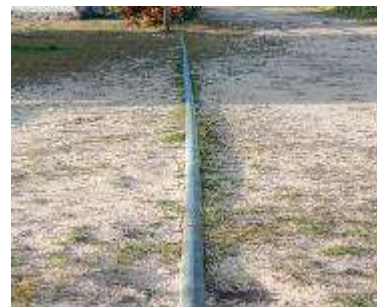
Kondisi Pipa PANSIMAS yang Sudah Rusak Terpotong
