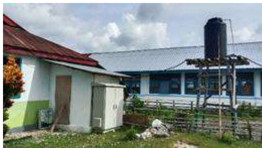
Genset dan Surya Panel di Puskesmas Letwurung
