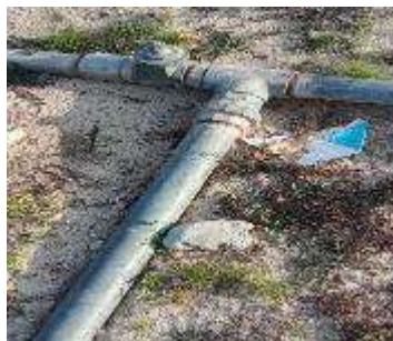
Kondisi Pipa PANSIMAS yang Terhubung di Desa Emplawas
