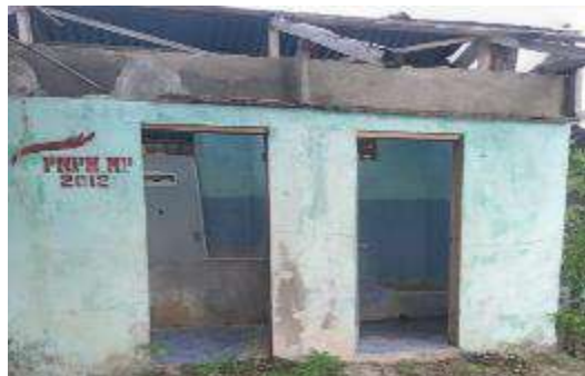
Gambar III-494 Jamban yang ada di Desa Tepa
