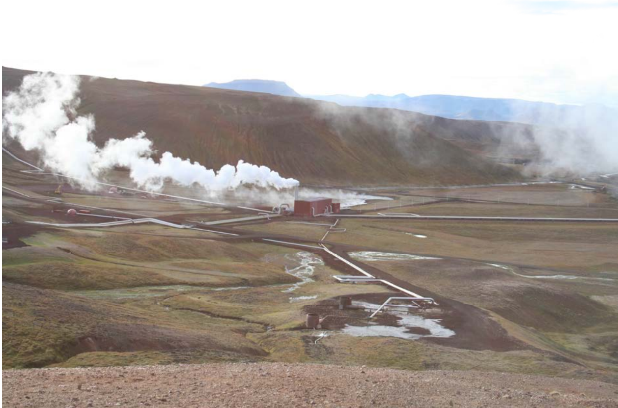
Mynd 16 Safnæðalagnir frá borholum á borsvæðum að skiljustöð og lokahúsi við Kröflustöð.
