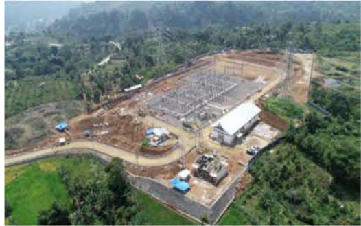
PLN Muara Labuh Substation
