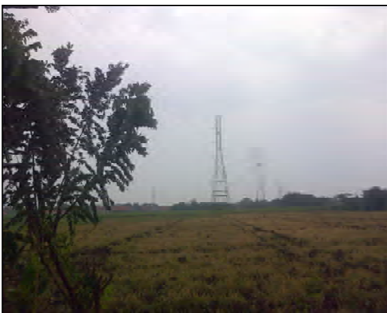
Gambar 3. Jaringan listrik eksisting yang berada di antara T.05 – T.06
