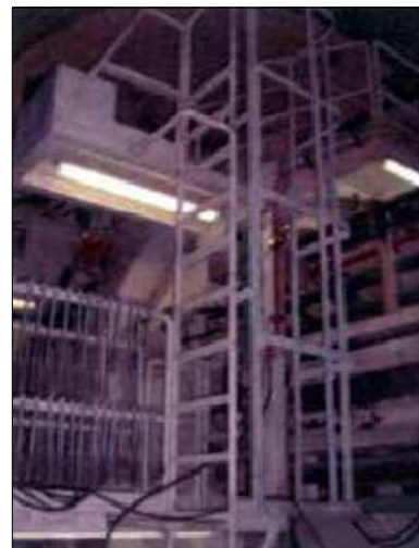
AROS EN LAS ESCALAS VERTICALES QUE COMUNICAN DIFERENTES PLATAFORMAS DE LA CABEZA. PROTECCIÓN FRENTE AL RIESGO DE CAIDA EN ALTURA
