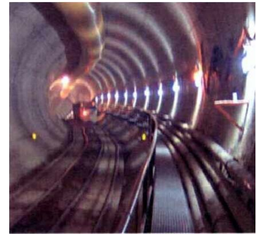
BALIZAMIENTO LUMINOSO EN TÚNEL
