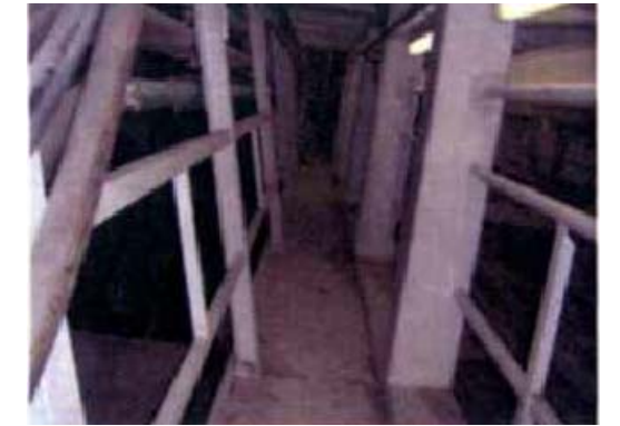
PROTECCIÓN FRENTE AL RIESGO DE CAIDA EN ALTURA. IMPLANTACIÓN DE BARANDILLAS Y RODAPIÉS EN LA PARTE EXTERIOR DE LAS PLATAFORMAS INFERIORES DEL BACK-UP
