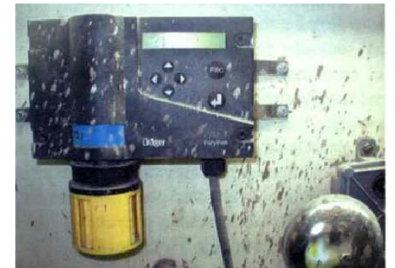
MEDIDORES DE O 2 Y CO EN TUNELADORA
