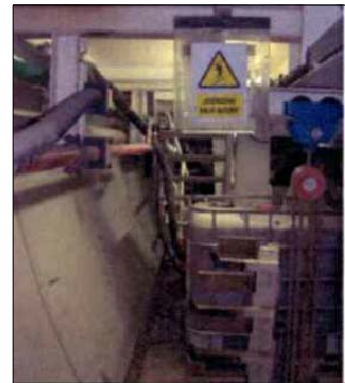
MEDIDAS IMPLANTADAS CONTRA RIESGOS DE ATRAPAMIENTO Y GOLPEO. APANTALLAMIENTO PLASTICO EN ZONAS DE GALIBO REDUCIDO
