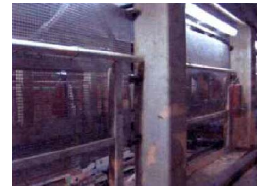
PROTECCIÓN CONTRA ATRAPAMIENTO Y GOLPEO EN LA ZONA DE DESPLAZAMIENTO DEL PUENTE GRÚA
