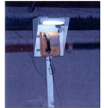
TELEFONIA FIJA EN TUNELES
