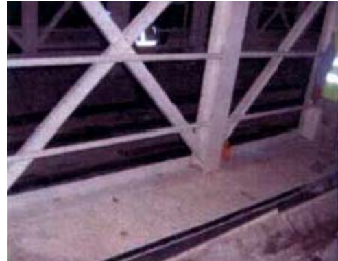
PROTECCIÓN FRENTE AL RIESGO DE CAIDA EN ALTURA COMPLEMENTACIÓN DE BARANDILLAS EN TRAMOS DEL BACK-UP CON CRUCES DE SÁN ANDRÉS
