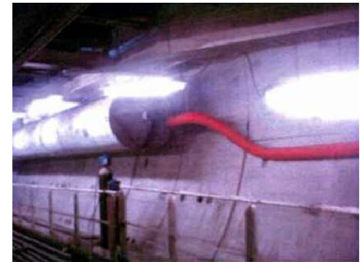
INSTALACIÓN DE TUBERÍA AUXILIAR CONECTADA AL VENTILADOR PRINCIPAL PARA INSUFLAR AIRE AL FRENTE
