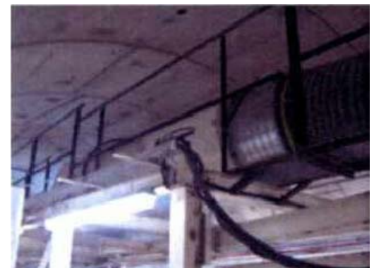
PROTECCIÓN FRENTE AL RIESGO DE CAIDA EN ALTURA. IMPLANTACIÓN DE BARANDILLAS Y RODAPIÉS EN LA ZONA DEL VENTILADOR
