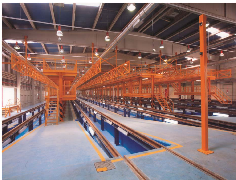
Figura 5.25: Imagen de nave de mantenimiento
