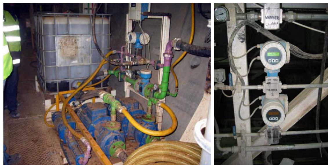
Figura 5.55 Sistema generador de espuma y caudalímetro de los distintos aditivos de la TBM-EPB empleada en la construcción de la prolongación de la línea 1 del metro de Madrid
