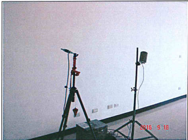
低頻噪音：彰濱線西工業區彰濱西二路自設變電站(105.09.18~19)
