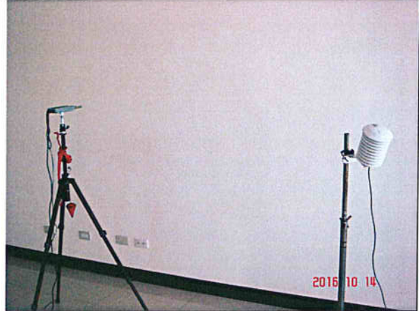
低頻噪音：彰濱線西工業區彰濱西二路自設變電站(105.10.14~15)
