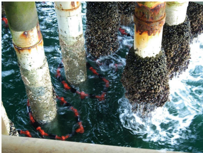
圖7.7.1-5 腐蝕的離岸風機基礎
