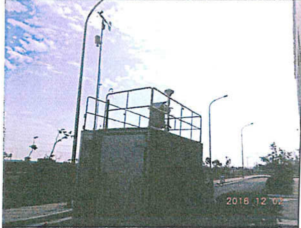
空氣品質：彰濱線西工業區彰濱西二路自設變電站(105.12.02-03)
