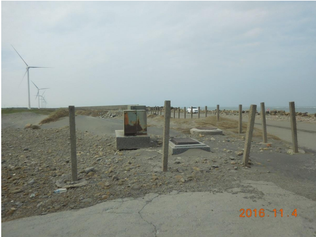
照片二十三 T7 量測點旁之變電箱
