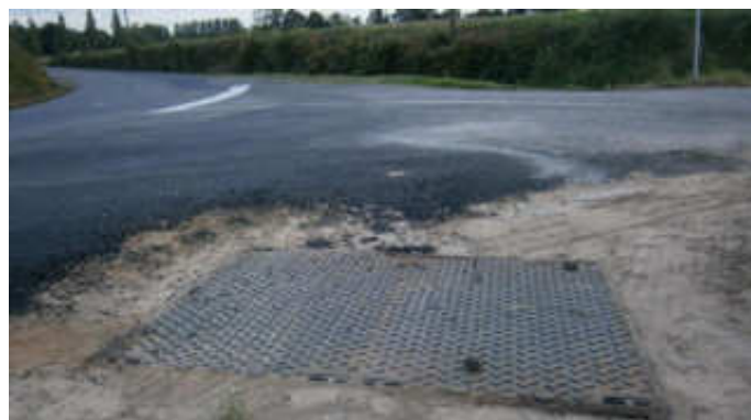
Regard pour gestion de la mise à la terre Source : RTE, 2016
