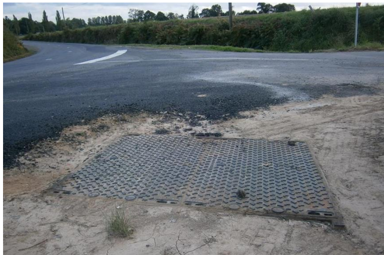
Regard pour gestion de la mise à la terre
