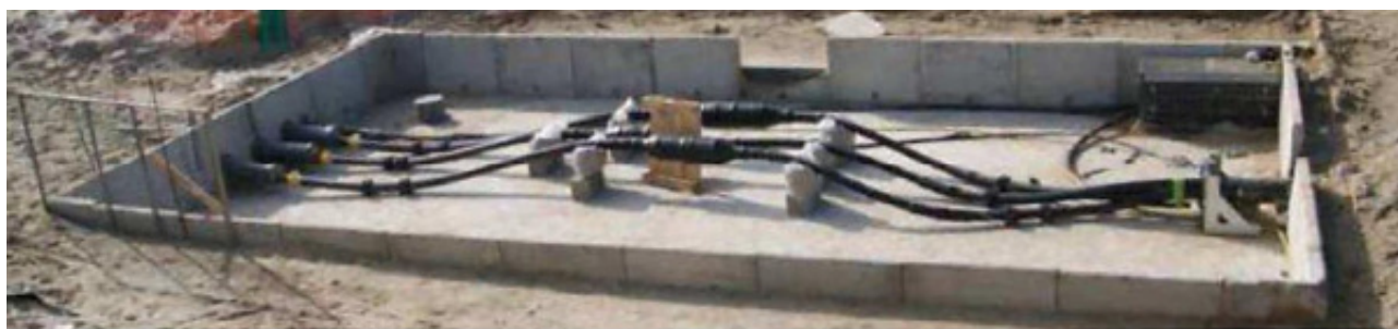
Figure 9 : Chambre de jonction d'atterrage
