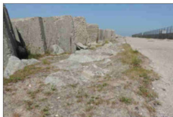
Accumulation de sable avec développement de la végétation
