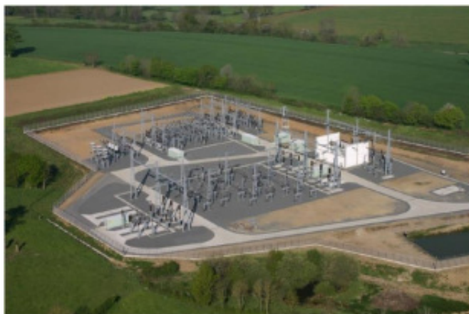
Figure 132 : Illustration d'un poste électrique 225 000 volts
