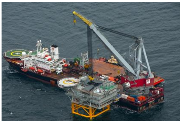
Poste électrique en mer ( www.offshorewind.biz )
