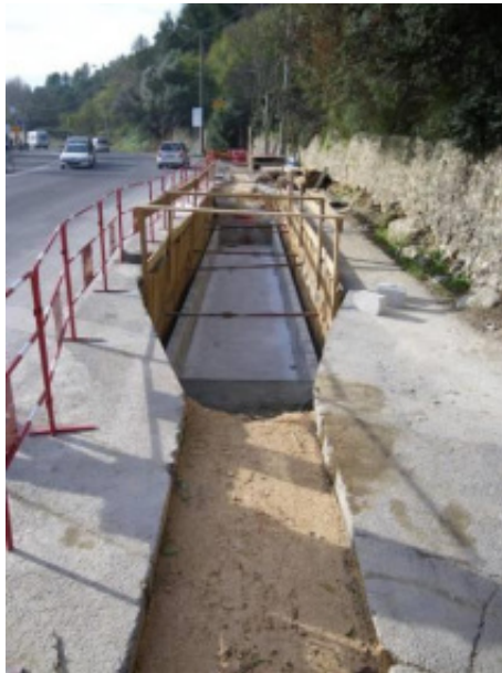
Figure 129 : Chambre de jonction pour une liaison composée d'un seul circuit 225 kV
