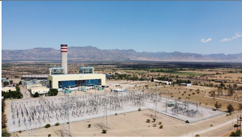
Figura 8. Subestación eléctrica 230 kV, de la CT Villa de Reyes.
