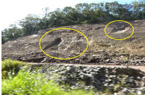
Foto 10.1-86: Detalhe de escorregamentos planares sobre rocha arenítica, cujas estruturas planares estão com a direção do caimento segundo a direção do talude de corte, fato que condiciona a instabilização de cunhas e porções do maciço, evidenciando escorregamentos planares sobre rochas sedimentares. Registro em talude de corte junto a BR-470 na região de Caieira, município de Navegantes/SC. Coord.: 22 J 722245 m E 7029590 m S.
