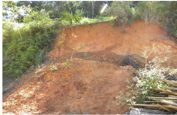
Foto 10.1-83: Detalhe de escorregamento circular, com movimentação de solo e rocha saprolítica (ver volume acumulado ao pé do talude). Situação decorrente da exposição do material em talude de corte subvertical (modificando a condição natural), observado na região de São Brás, município de Navegantes/SC.22 J 717762 m E 7038797 m S.
