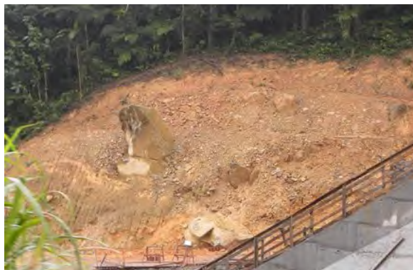
Foto 10.1-87: Detalhe de rocha fresca incorporada a maciço saprolitizado, condição que dificulta a escavação do maciço e possibilita a queda e rolamento destes blocos, observado na região do Ribeirão Manso, município de Jaraguá do Sul/SC, divisa com Joinville/SC. Coord.: 22 J 683886 m E 7088094 m S.
