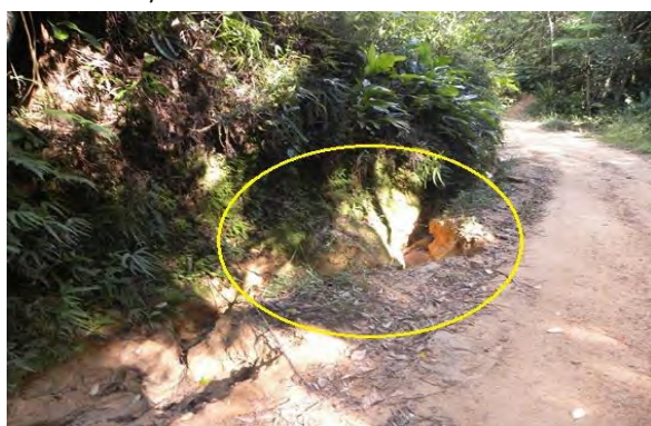
Foto 10.1-91: Detalhe da evolução de erosão linear ao longo da margem de uma via local, cuja condição é agravada pela concentração de água na estrada, pela inclinação do terreno e pelo tipo de material saprolítico, por sobre o qual o processo vem evoluindo. Observado em via de acesso na região de Nova Itália, município de Brusque/SC. Coord.: 22 J 715157 m E 6998748 m S.
