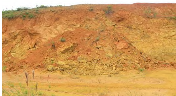
Foto 10.1-84: Detalhe de escorregamento circular envolvendo solo superficial (argissolo) e rocha saprolítica, em função de corte subvertical efetuado no terreno, associado a morro baixo, na região de Pedra de Amolar, município de Corupá/SC. Coord.: 22 J 676683 m E 7073999 m S.
