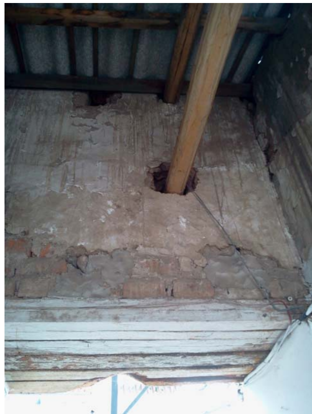
Detalle de daños al interior del Hospital San Lázaro
