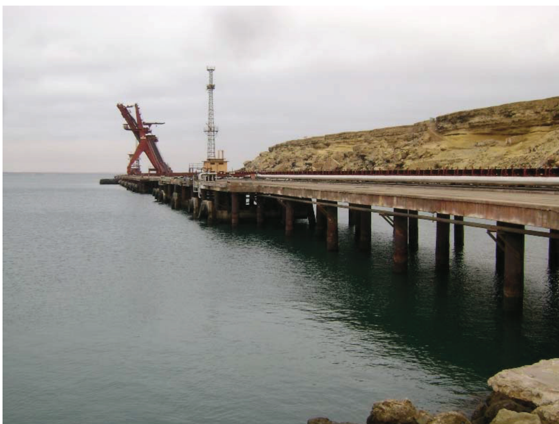
Fotografia 3.8 – Ponte-cais do Porto de Sacomar, que será alvo de reparações estruturais no molhe e nos pilares
