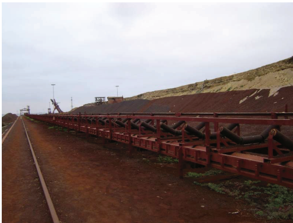
Fotografia 3.6 – Sistema de tapetes rolantes, para transporte do minério. Os tapetes rolantes serão substituídos ou, quando viável, reabilitados e reequipados
