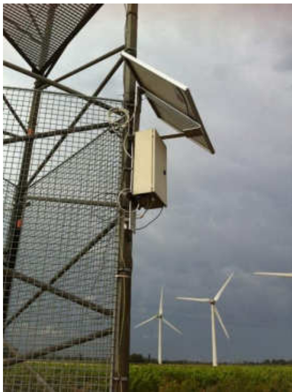
Photographie 9 : Exemple de dispositif d'enregistrement acoustique avec alimentation par panneau solaire (installé sur un mât treillis)
