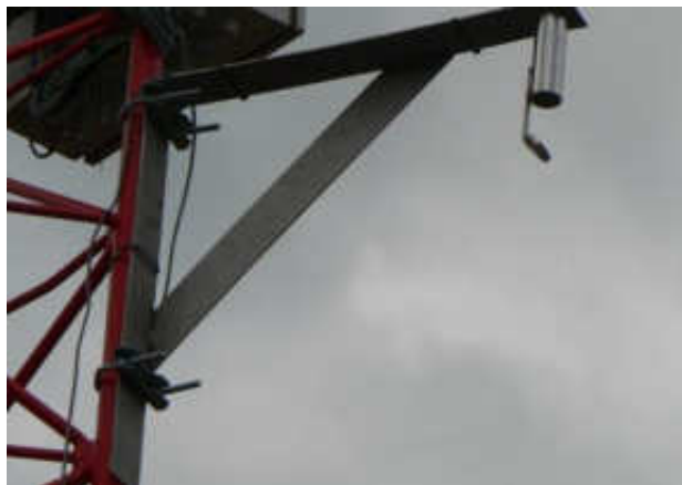
Photographie 10 : Exemple de système de protection du microphone (potence acier)
