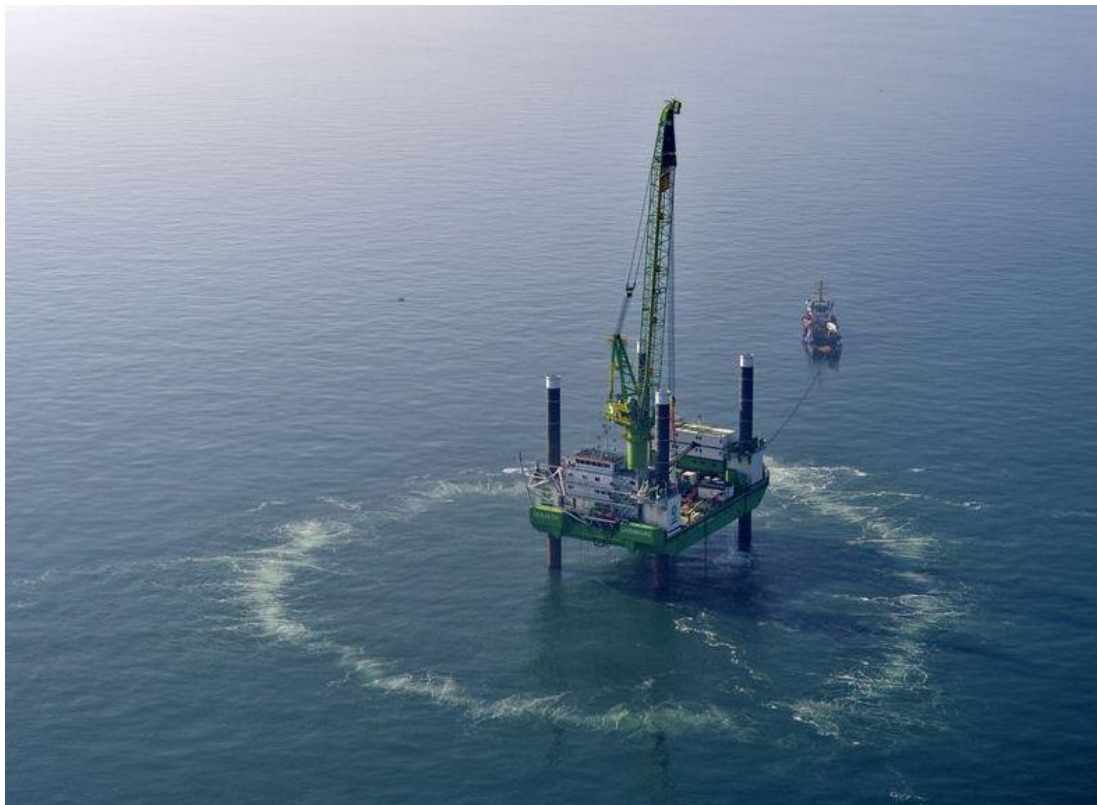
Figure 121 : Rideau de bulles mis en place en mer du Nord autour d'une plateforme de battage
