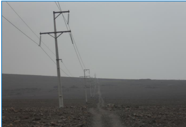
S/E Mejillones – Muelle Esperanza
