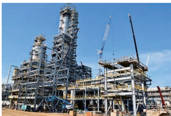
ポリエチレン製造プラント
