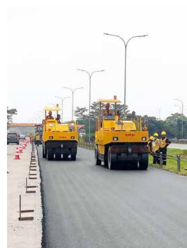
インドネシアでのリサイクルアスファルトの施工状況
