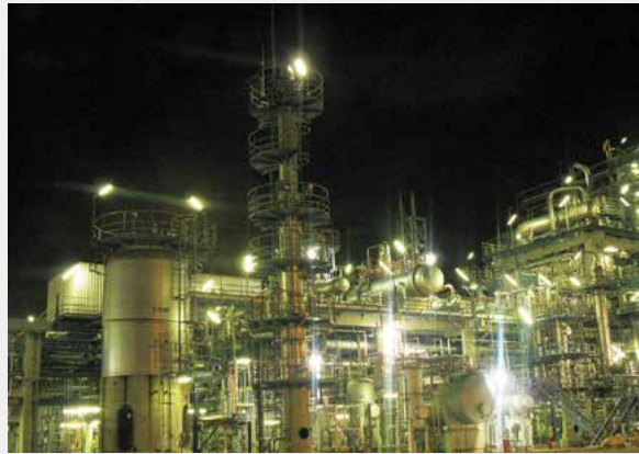
シンガポールのタフマー®既存製造プラント(提供：MELS)
