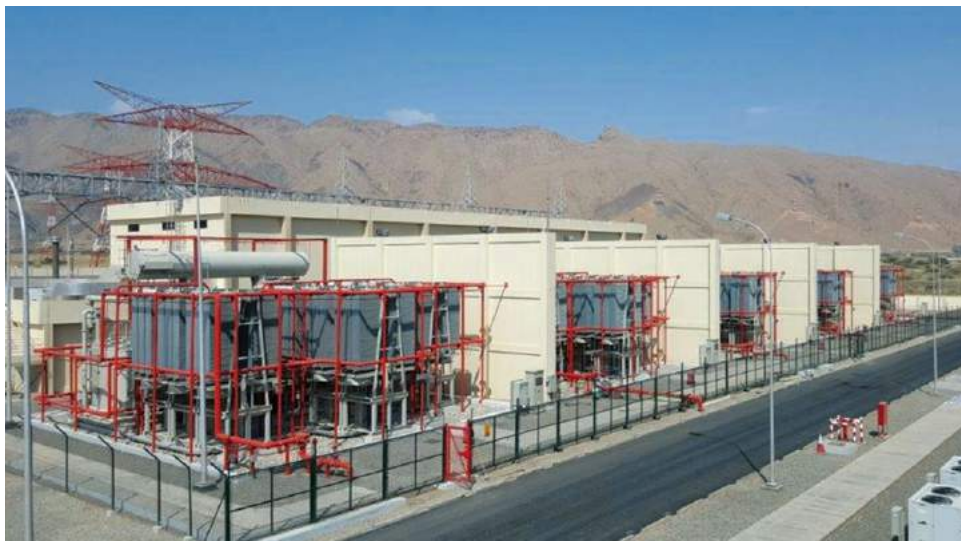
イラク変電所
