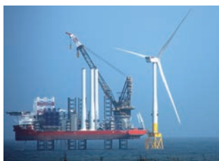
Moray East 洋上風力発電事業
