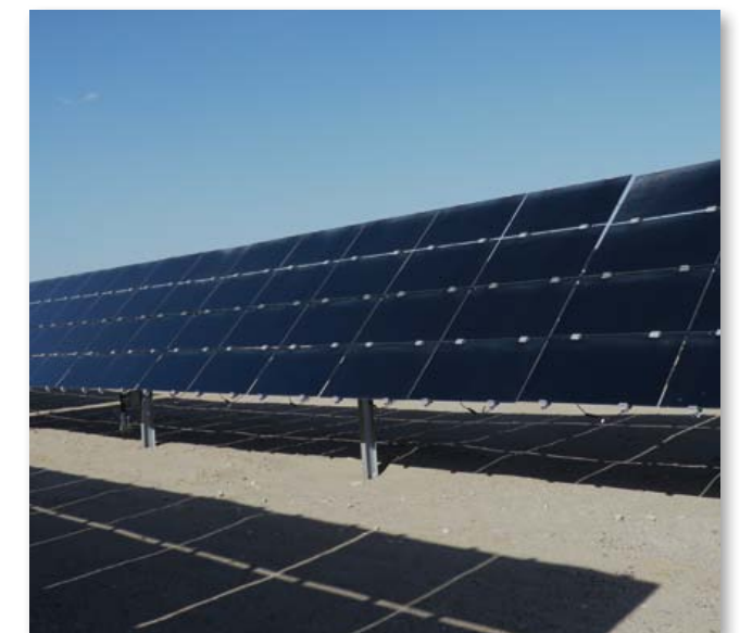
日照角度に伴い角度を変えるパネル。常にクリーンに保たれている。
