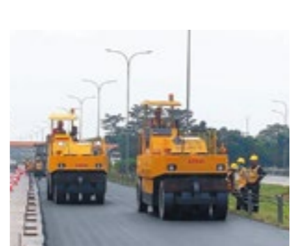
インドネシアでのリサイクルアスファルトの施工状況。
